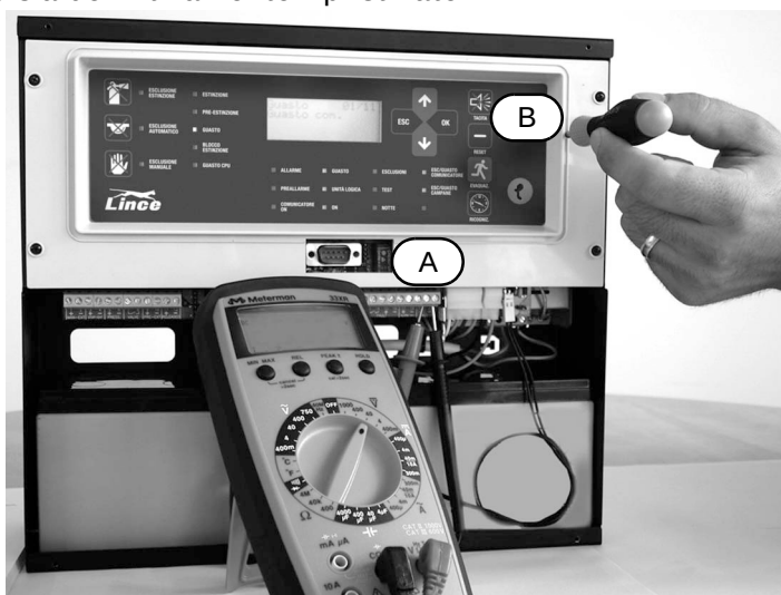
Figura 37 - Taratura tensione batterie
